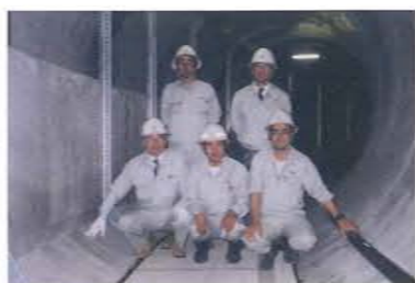
工事主任として、管理をまかされた現場。毎日が楽しくて、現場に行くのが楽しみだった。 ※写真は、シールド坑内にて現場関係者と撮影したもの。入社6年目撮影
